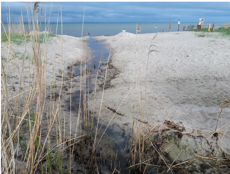
Fot. 20. Częściowo zasypane piaskiem i zarośnięte ujście Kanału Beka do Zatoki.
